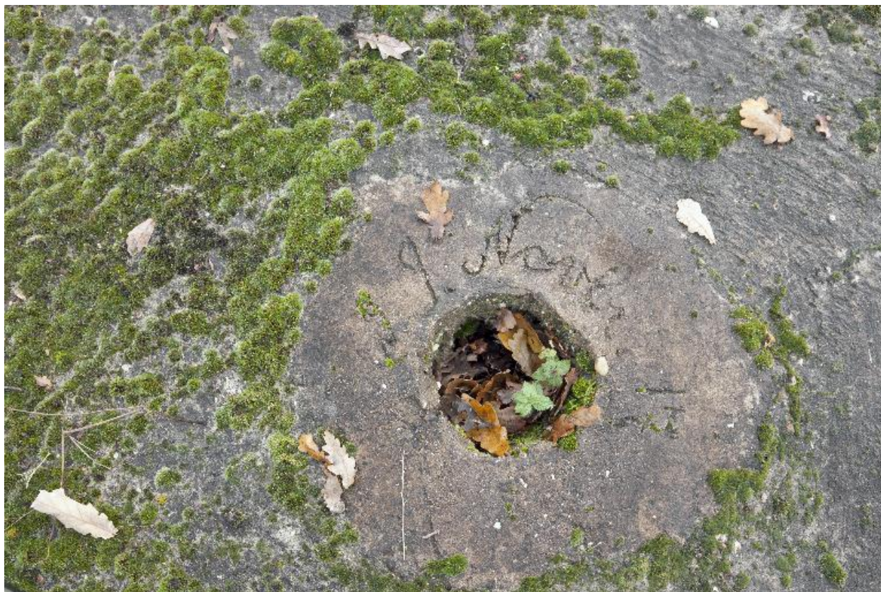
Chronogramme autour d'une sortie de cheminée d'aération.
