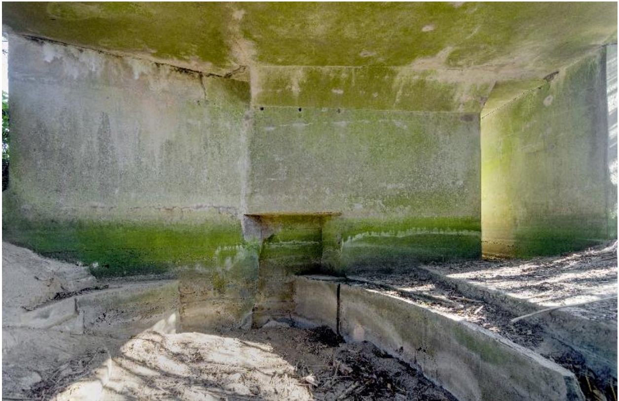
Depuis la cuve à canon de la chambre de tir, vers l'est et avant déblaiement.
