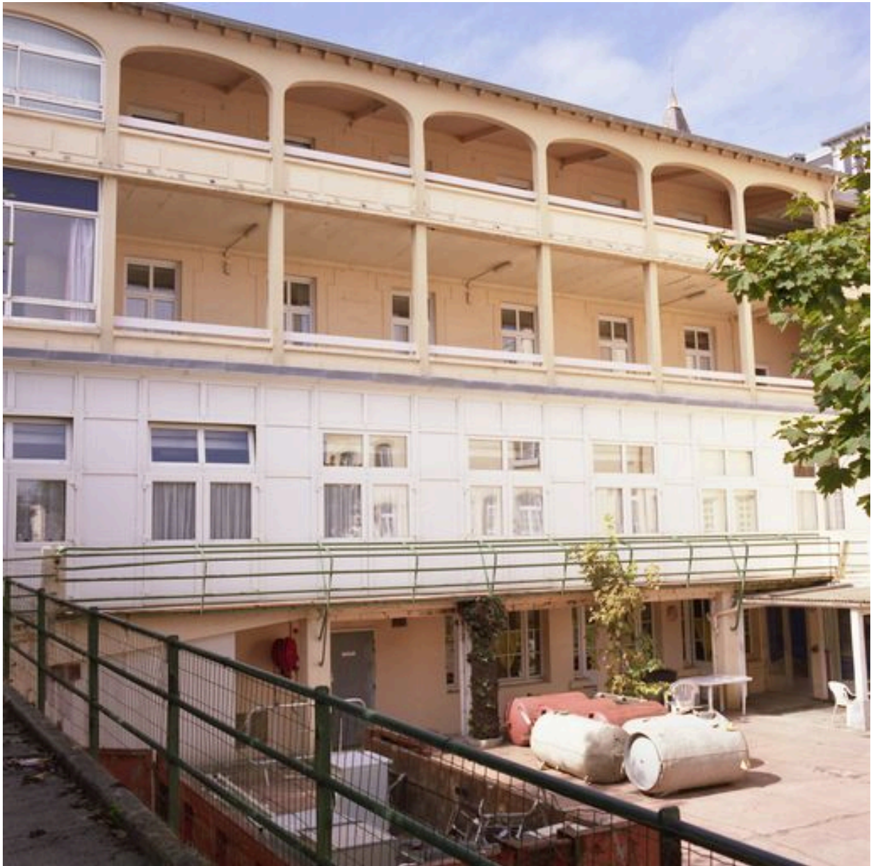
Revers du bâtiment donnant du côté de la rue Eugène-Trigoulet avec ses galeries de cure conservées en parties hautes, vue de trois-quarts gauche.
