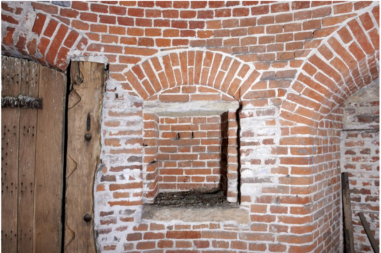
Niveau principal (R+1). Petite niche murale carrée à proximité de la porte d'accès.
