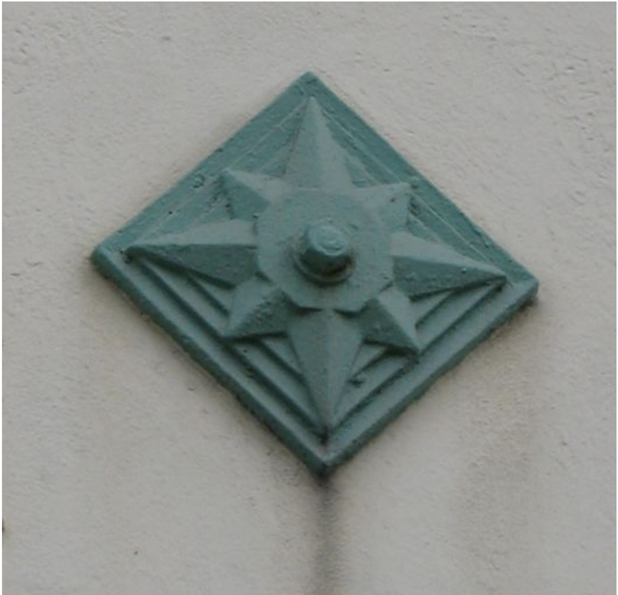
Fer d'ancrage de l'un des chaînages sur le mur de l'ancienne usine électrique.
