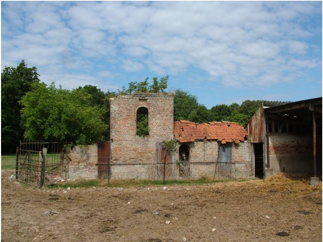
Bettencourt-Saint-Ouen. Vestiges de l'ancienne ferme (n°2) de Bachimond, 4e quart 19e siècle.
