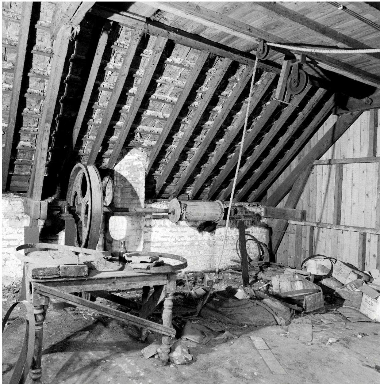
Moteur du monte-sacs de la malterie.
