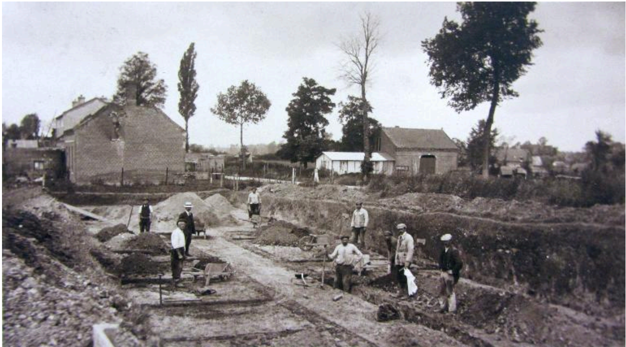
Fondations du bâtiment de réfectoire de la sucrerie, 9 juillet 1920 (AD Somme ; 49 Fi 29).
