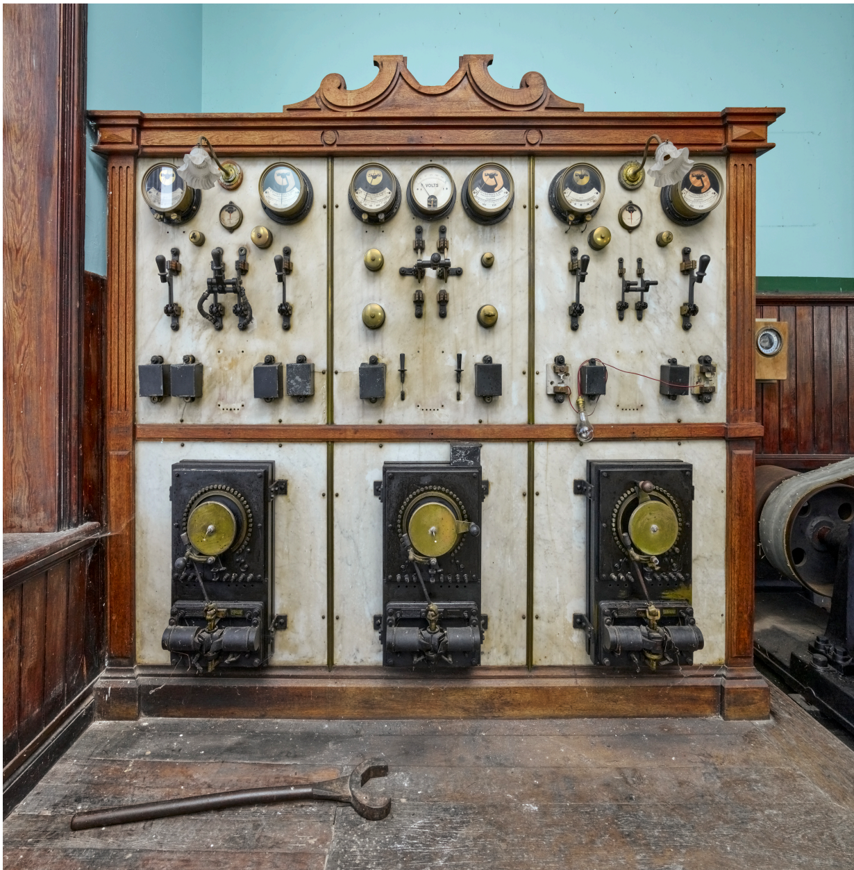
Intérieur, tableau de contrôle.
