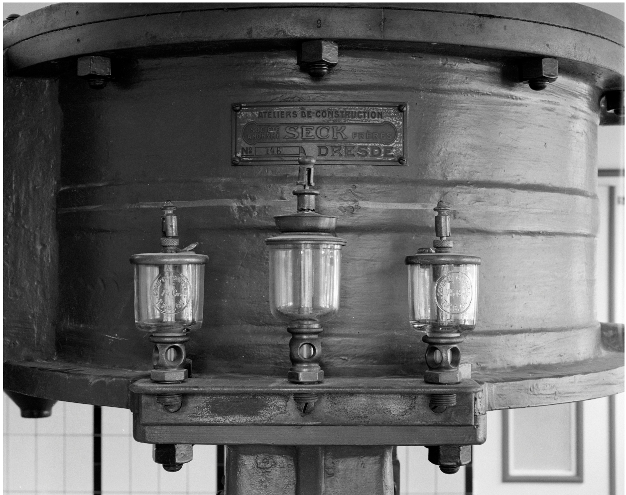
Pompe à vide à membrane. Atelier de construction Seck Frères (Dresde) : plaque de constructeur et graisseurs.
