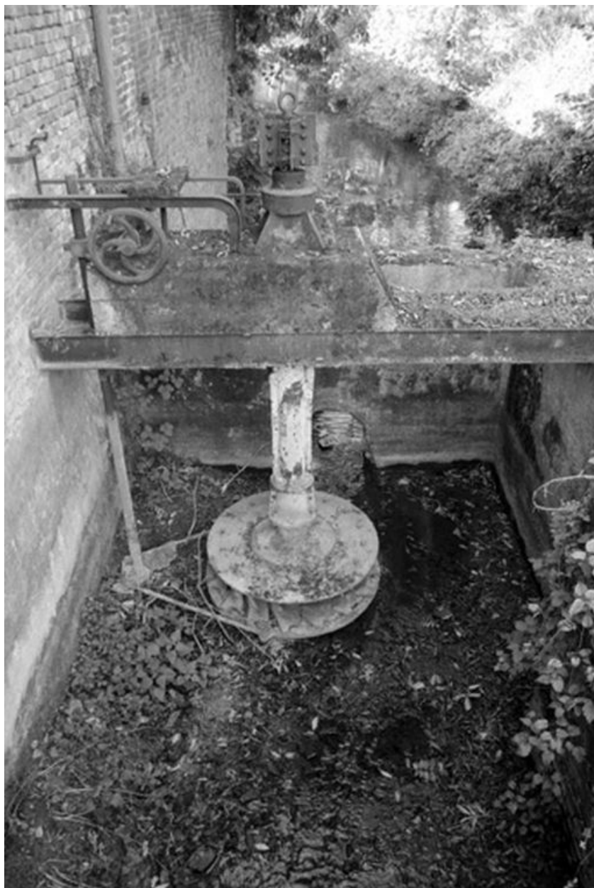
Détail de la turbine hydraulique.
