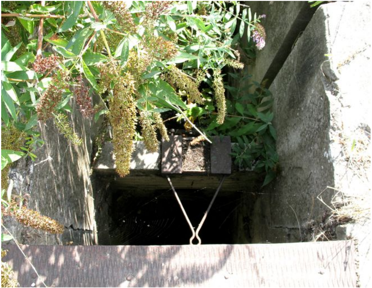
Prise d'eau dans l'Oise.
