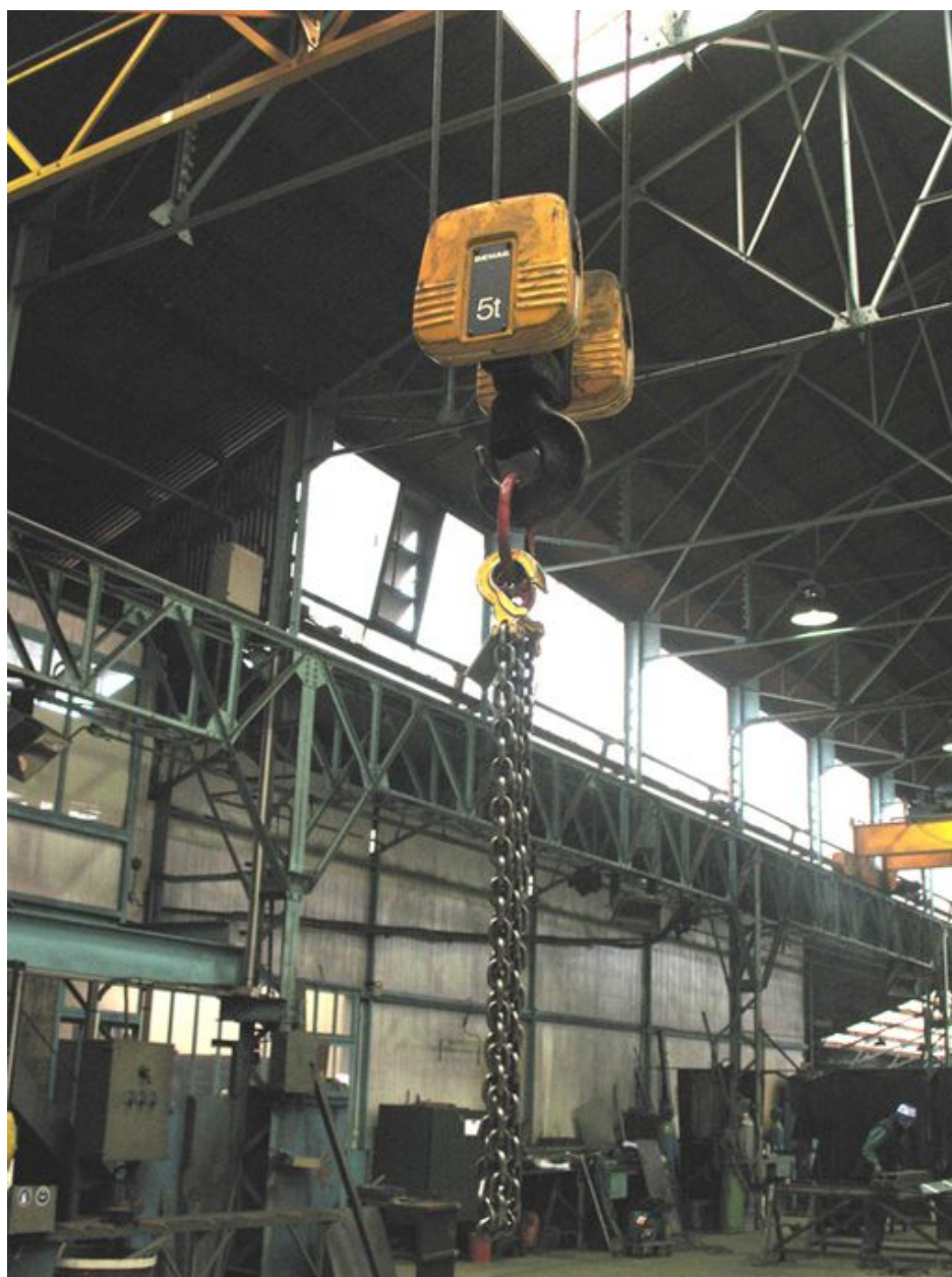
Grue de levage de 5 tonnes.
