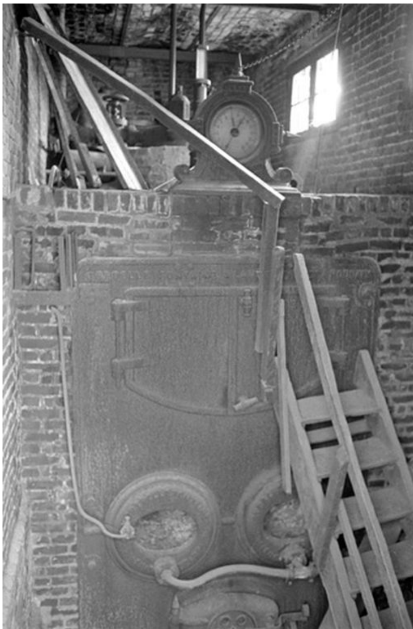
Chauferrie, vue intérieure : chaudière à vapeur (Crepelle-Fontaine), vers 1990.
