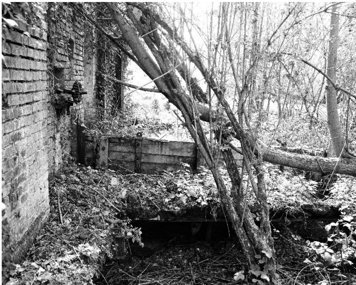
Vannes de décharge.
