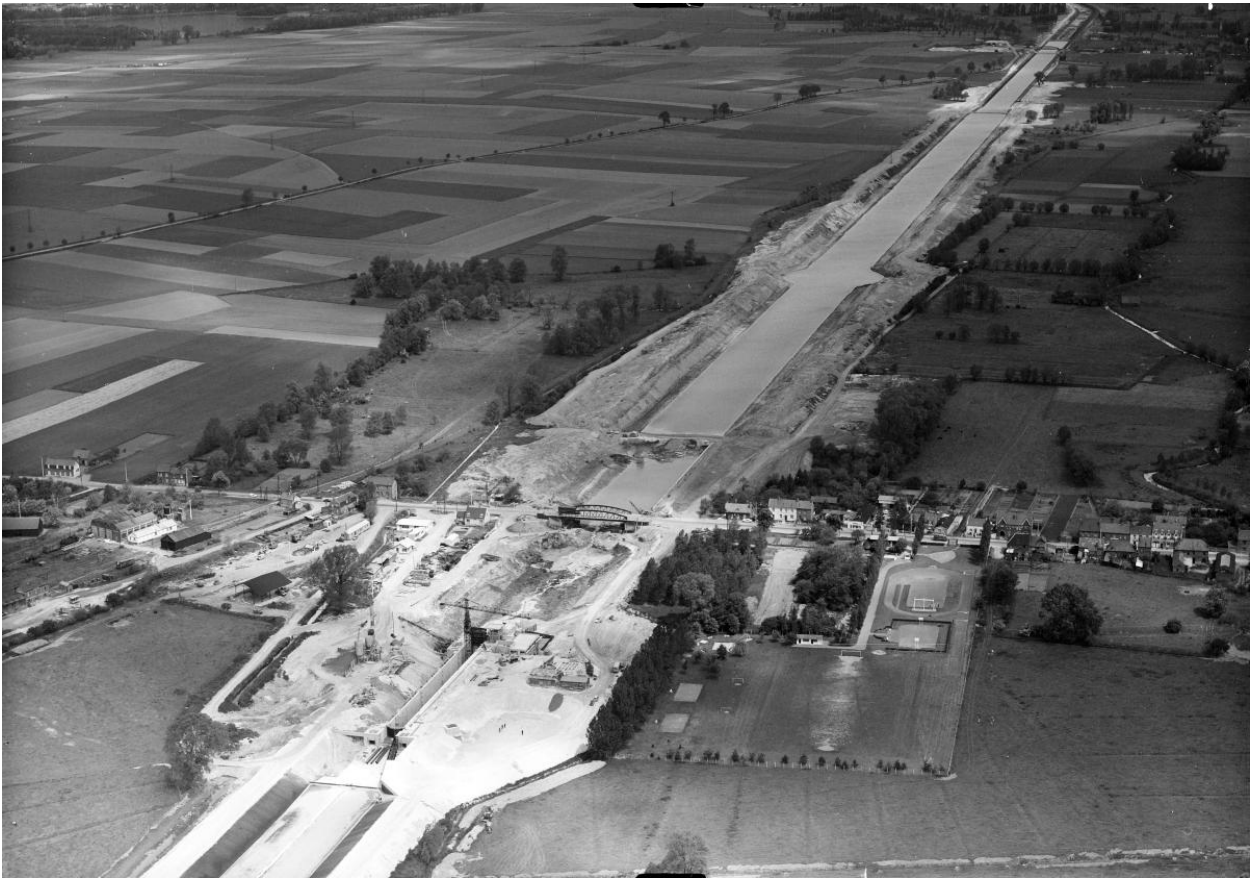
Chantier de construction du canal du Nord. Vue aérienne du port de Marquion lors de la seconde phase de chantier en 1965. (IGN. Photothèque Nationale).
