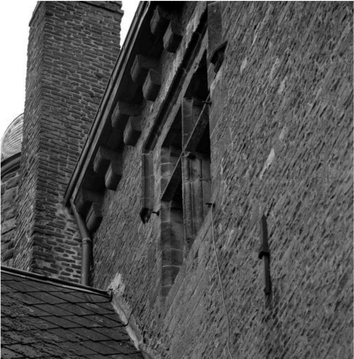
Corps de logis médiéval, façade arrière, travée nord-ouest, 2e étage, vue partielle : baie à croisée de pierre (grande salle), corbeaux de pierre.
