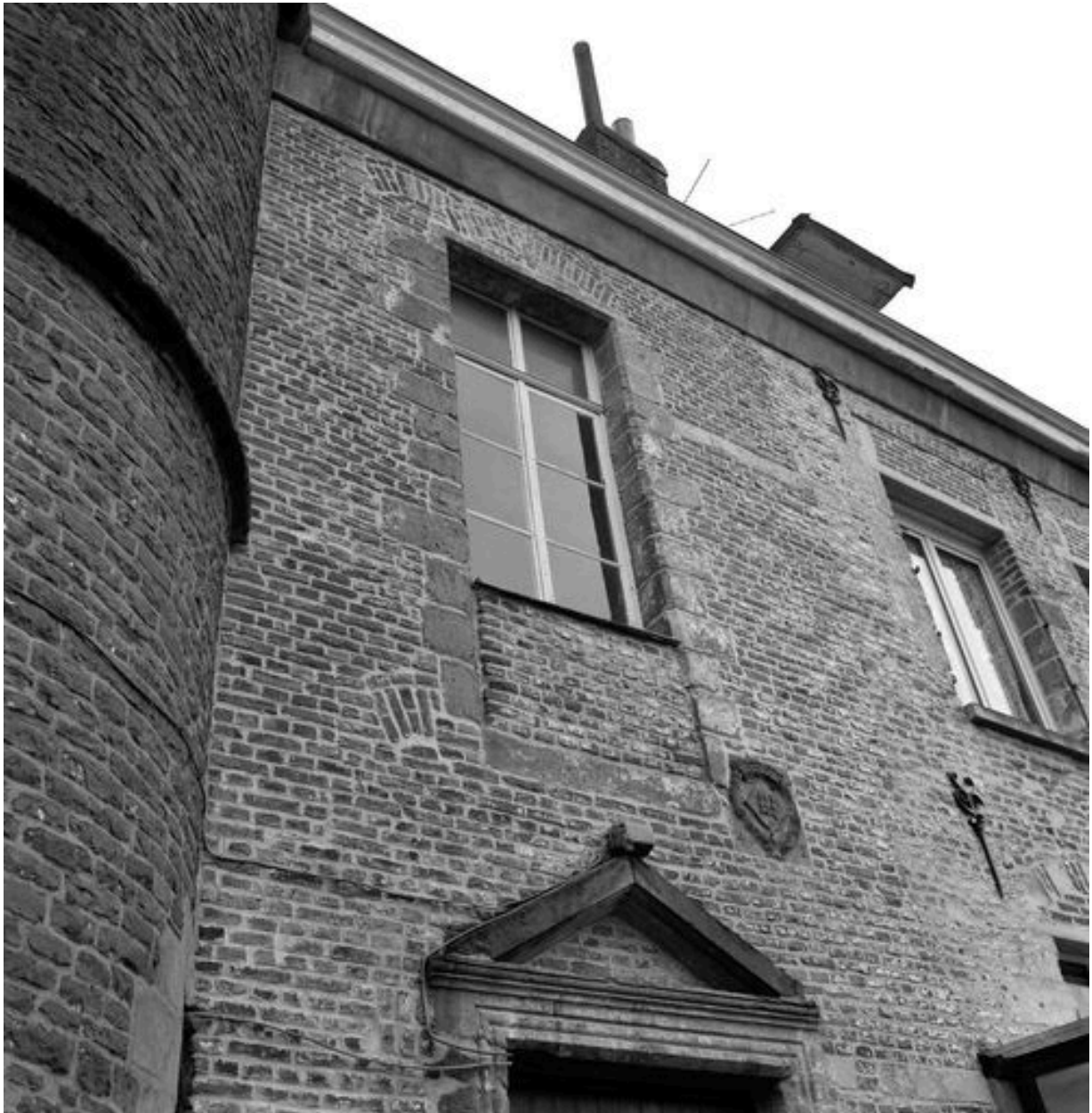
Aile de la rue de la Cavalerie : façade arrière du n° 35, vue partielle : 1er étage, reprises de percements.
