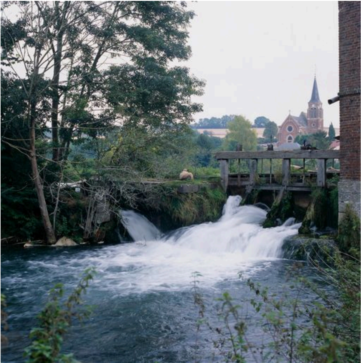
Le vannage de décharge.
