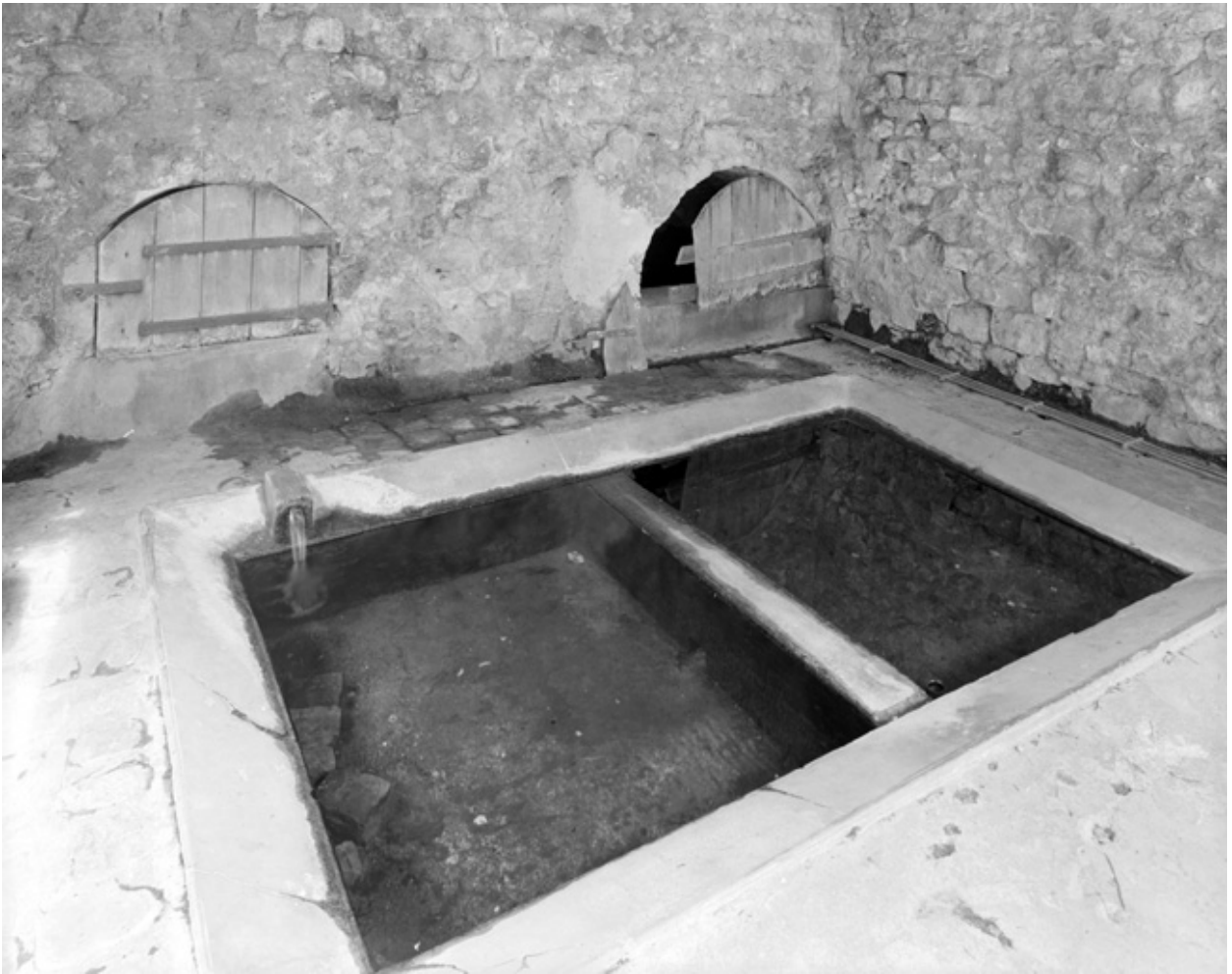
Rue de Bue. Lavoir : vue du bassin et des portes des réservoirs ou conduits d'arrivée d'eau.
