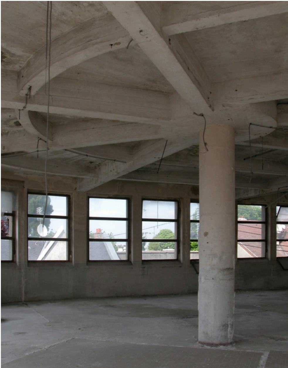
Ateliers des années 1946-48 : détail du système poteau-poutre de la structure en béton armé.
