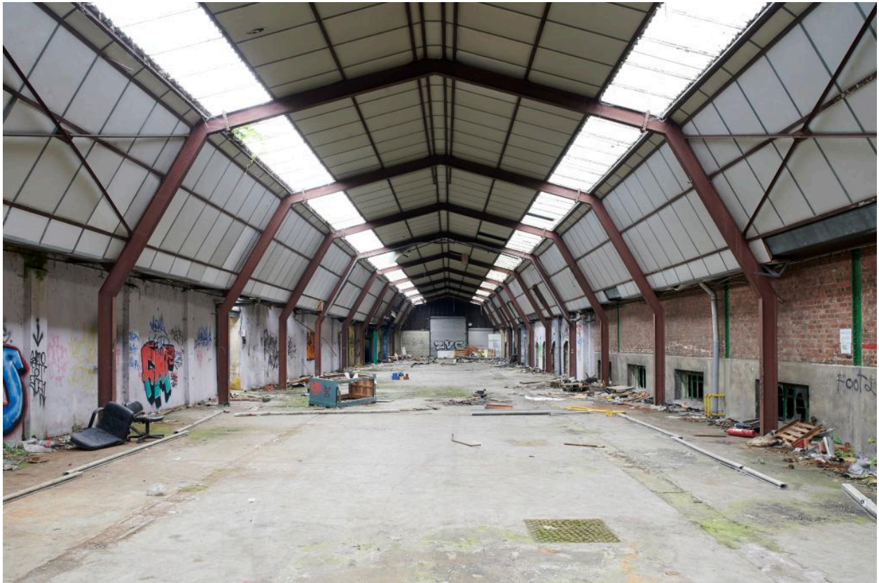
Vue intérieure de la charpente métallique à fermes polygonales du magasin nord.
