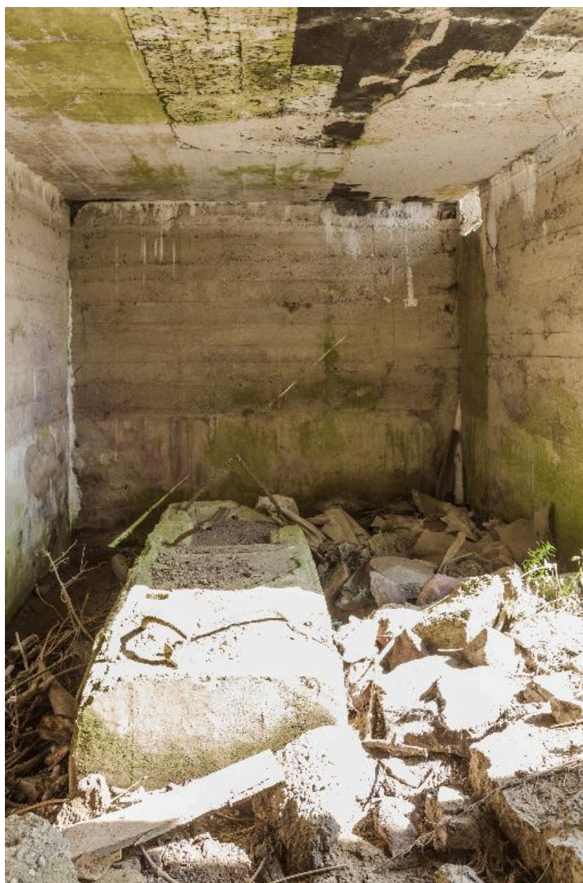
Bâtiment 2, massif bétonné des pompes
