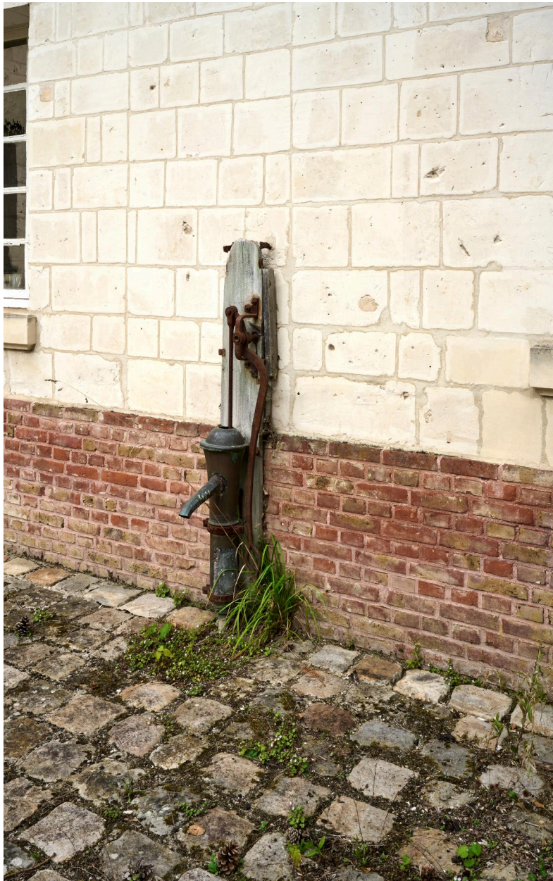
Pompe à eau installée contre le château.
