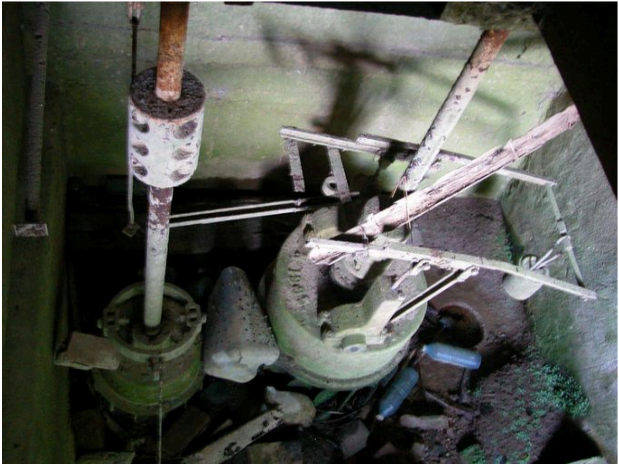
Vue de dessus des deux turbines.
