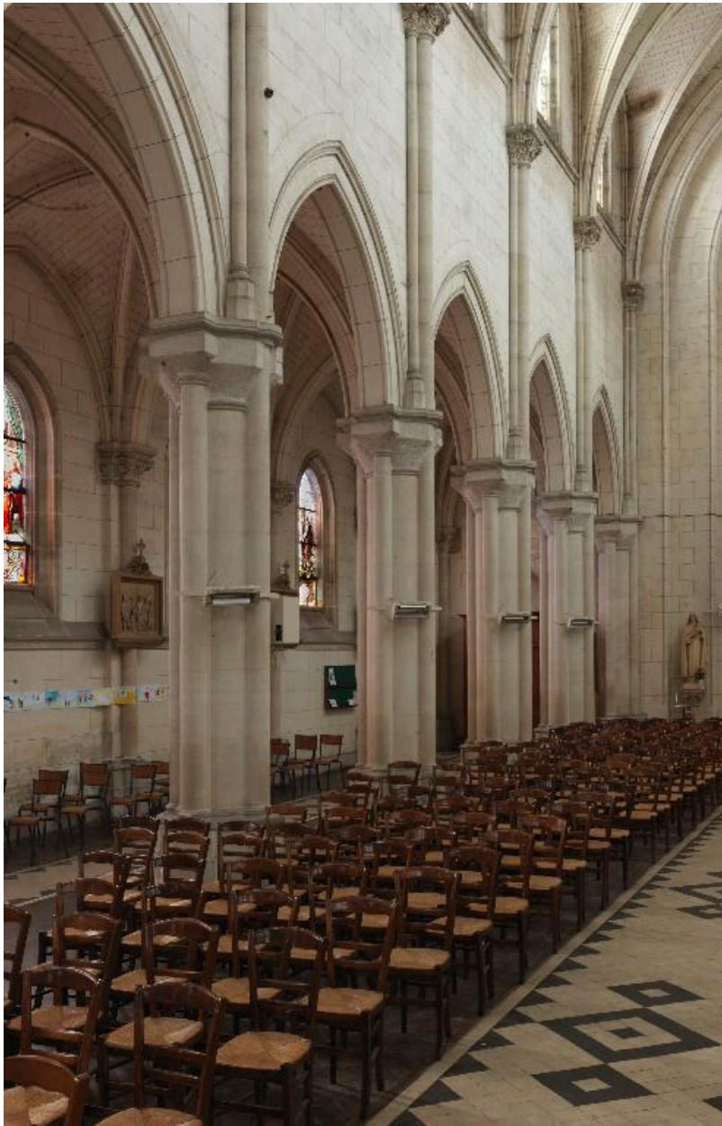
Vue intérieure des arcades et des colonnes séparant la nef du bas-côté nord.
