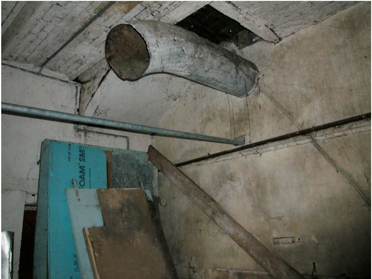
Détail de l'arrivée de la conduite forcée qui alimentait la roue hydraulique par dessus.
