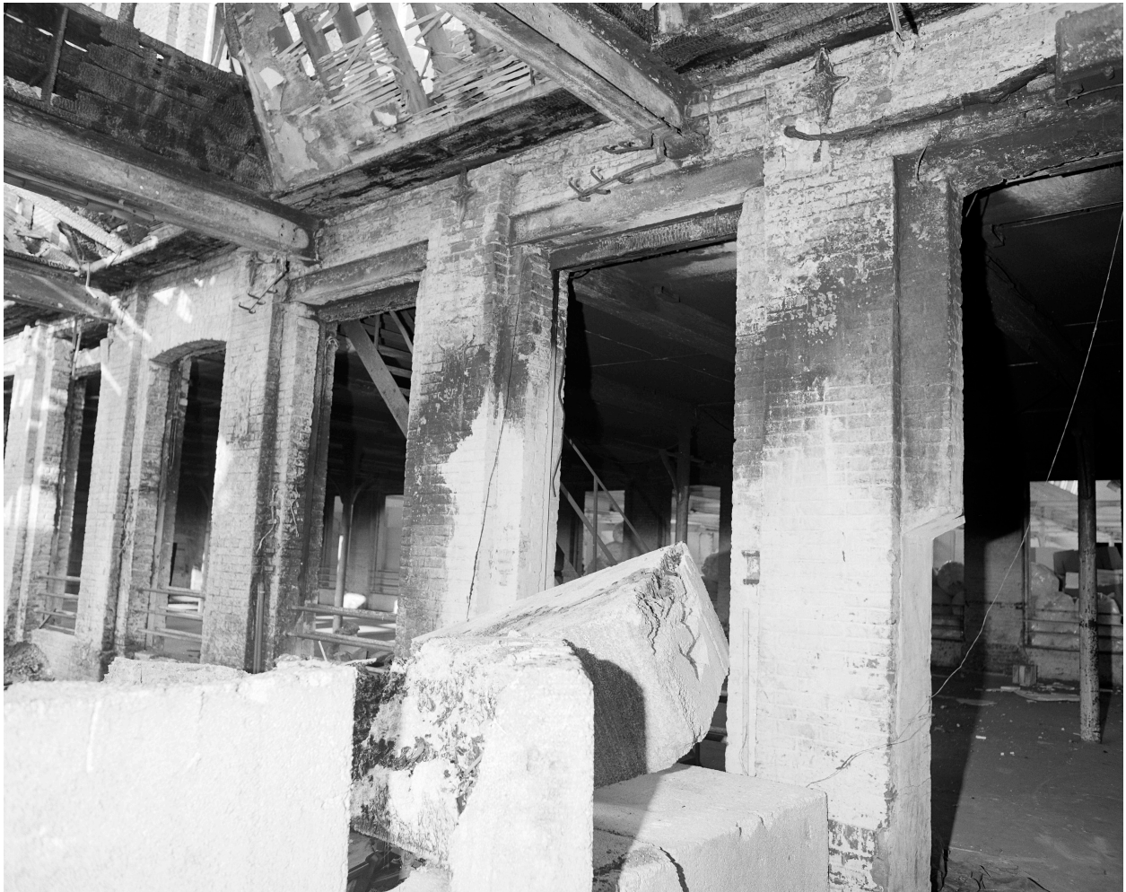
Atelier de fabrication après incendie, rez-de-chaussée.
