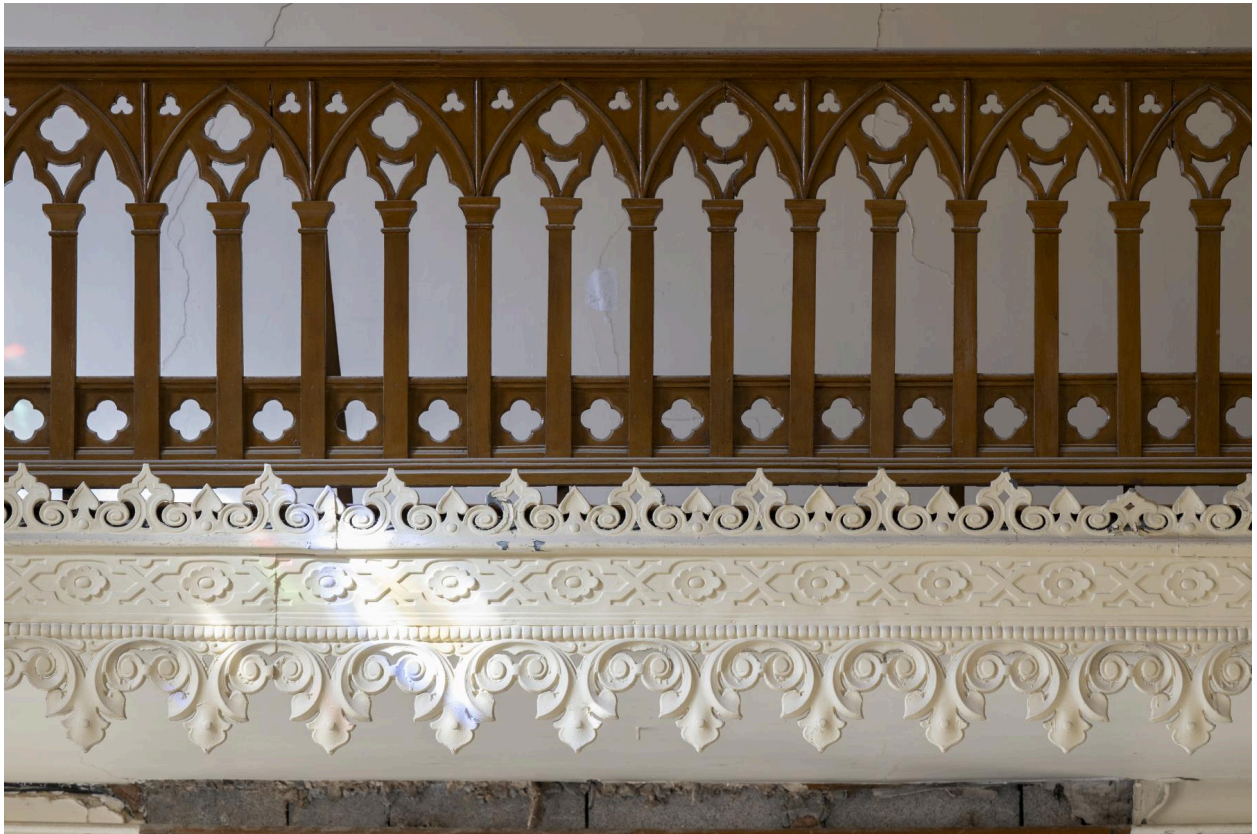
Vue de détail de la clôture de la tribune avec son lambrequin.
