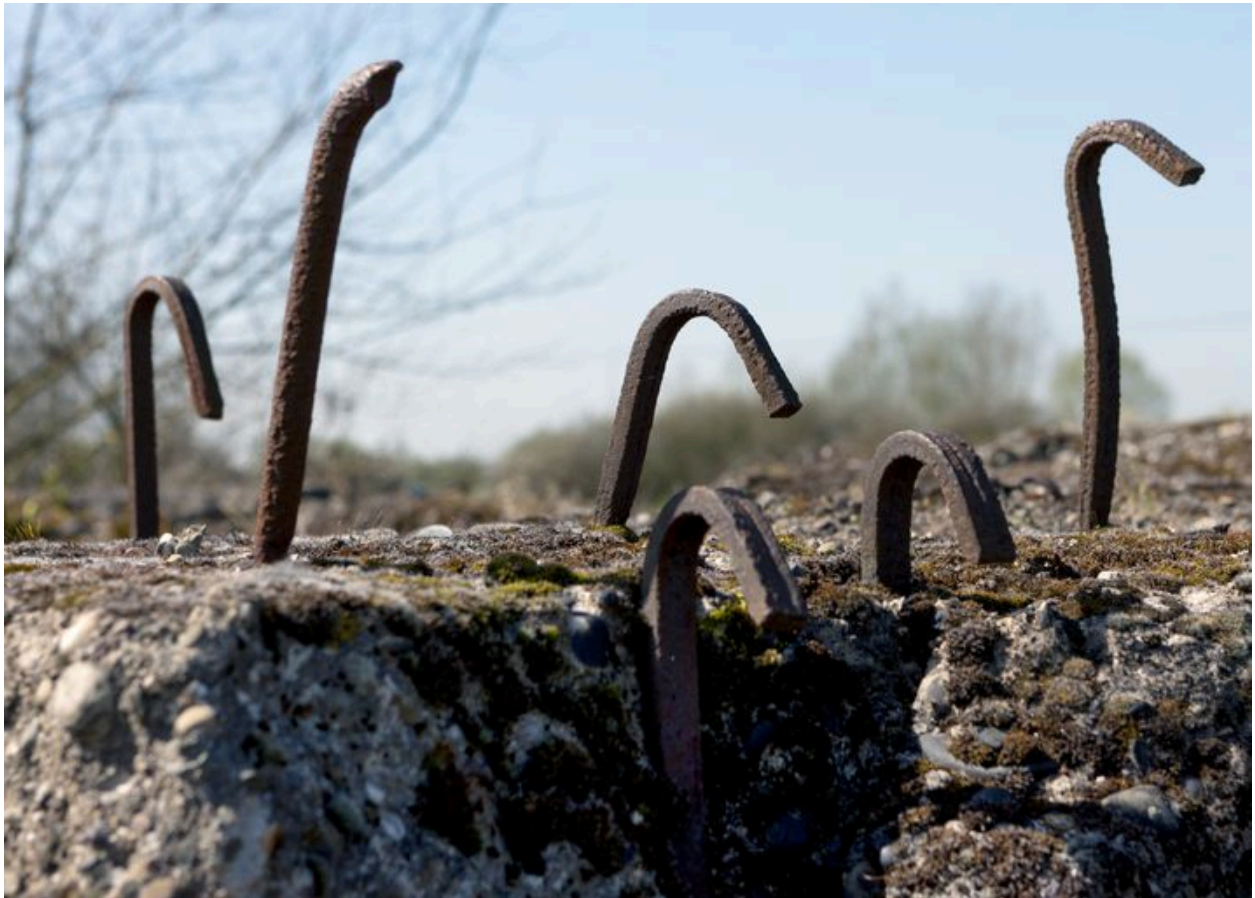
Bâtiment A : Partie explosée du toit, détail du ferrailage
