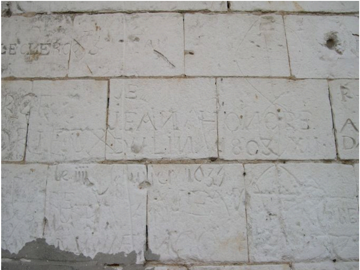
Mur nord du bas-côté nord : Graffiti.
