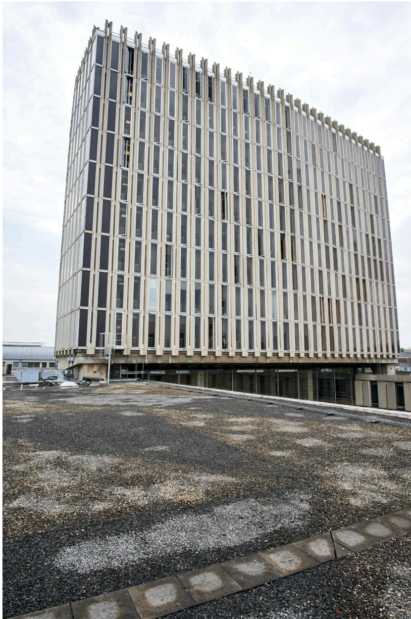
Façade sud de la tour, vue prise depuis le toit-terrasse du bâtiment bas.
