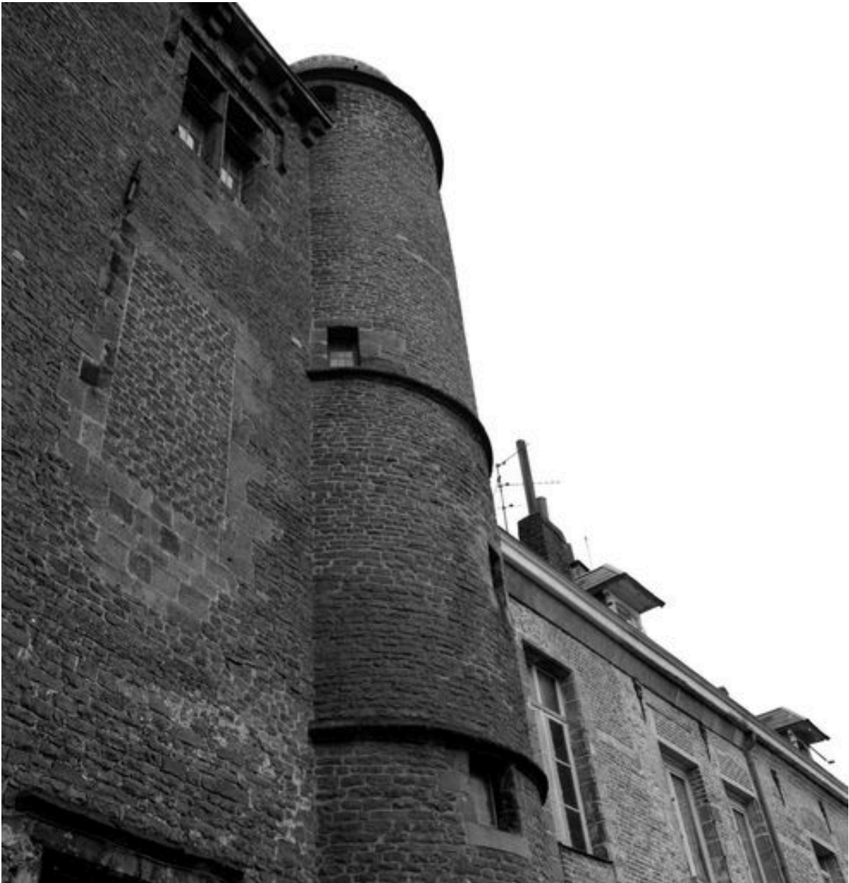
Corps de logis médiéval, façade arrière, vue partielle : baie occultée au 1er étage, baie du 2e étage (grande salle) et tourelle d'escalier (ouest).
