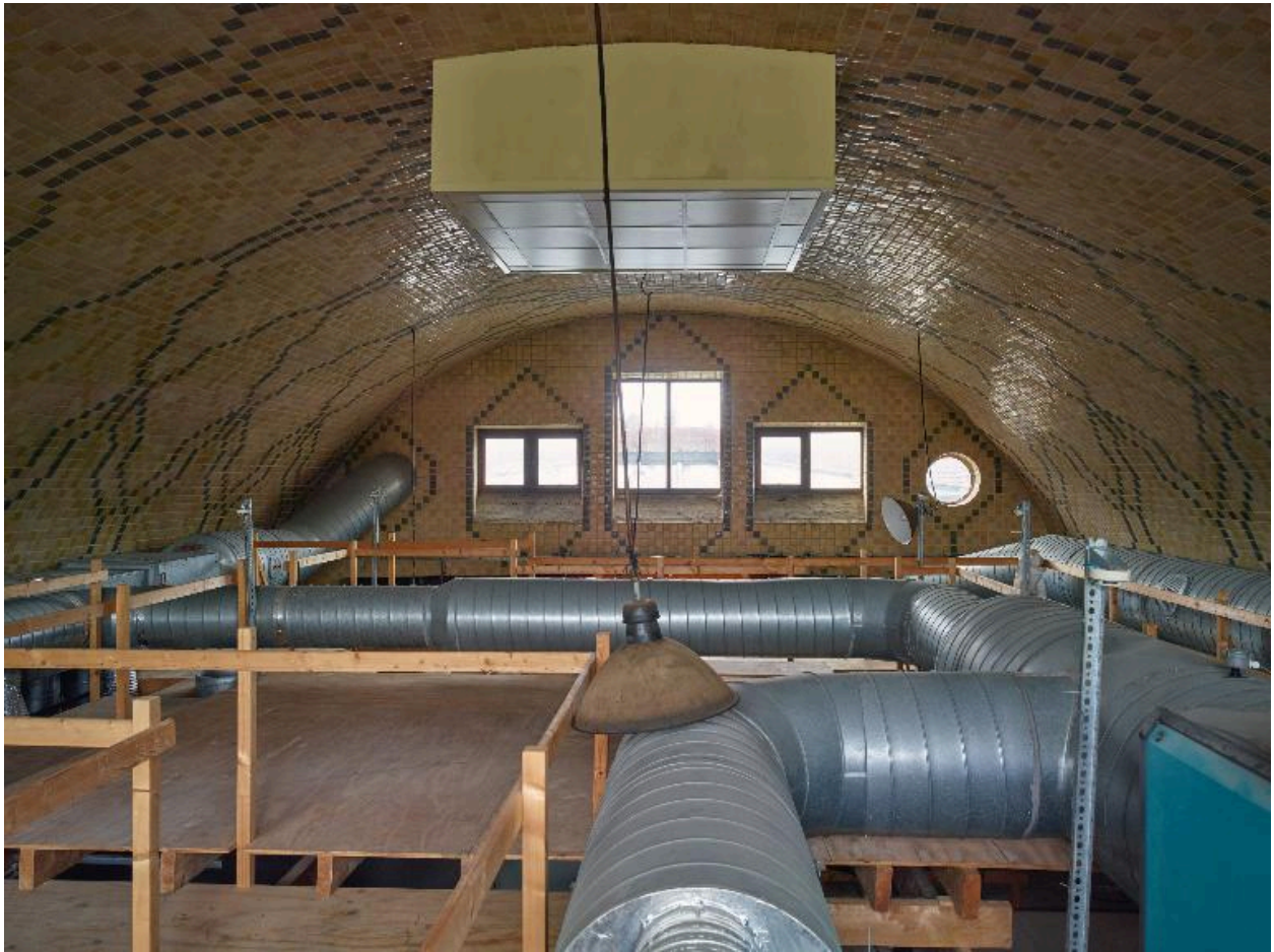
Bâtiment des cuisines, salle centrale actuellement divisée par un plancher, détail du voûtement visible au-dessus de ce plancher, vue vers le revers de la façade postérieure.
