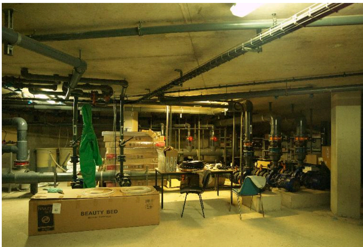
Vue générale du local technique.
