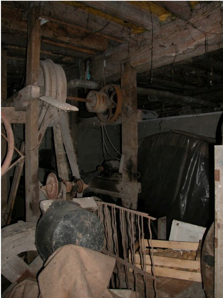
Intérieur de la salle des machines, vue des arbres et des poulies de transmission.
