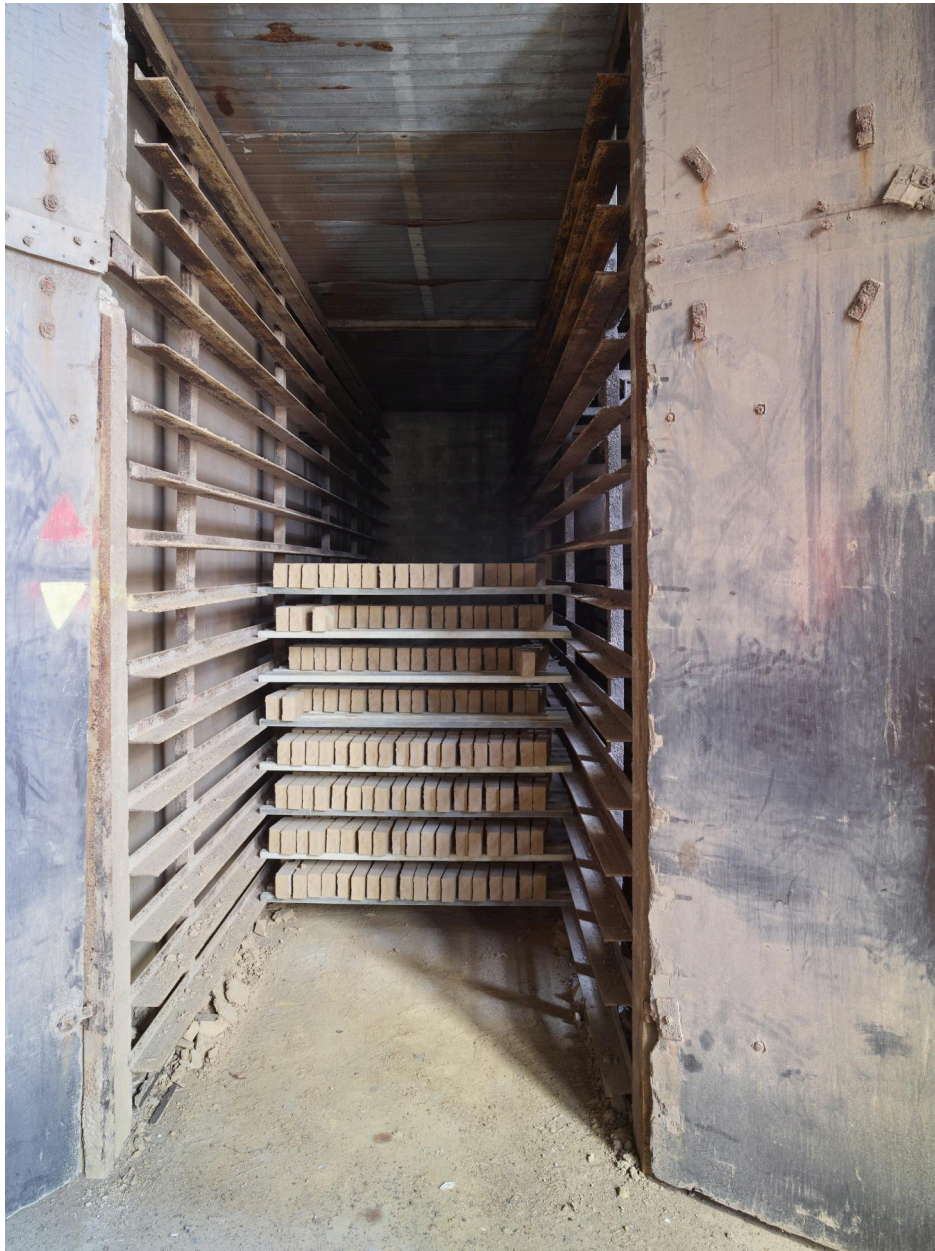
Hangar des séchoirs (étuves). Claies de séchage.
