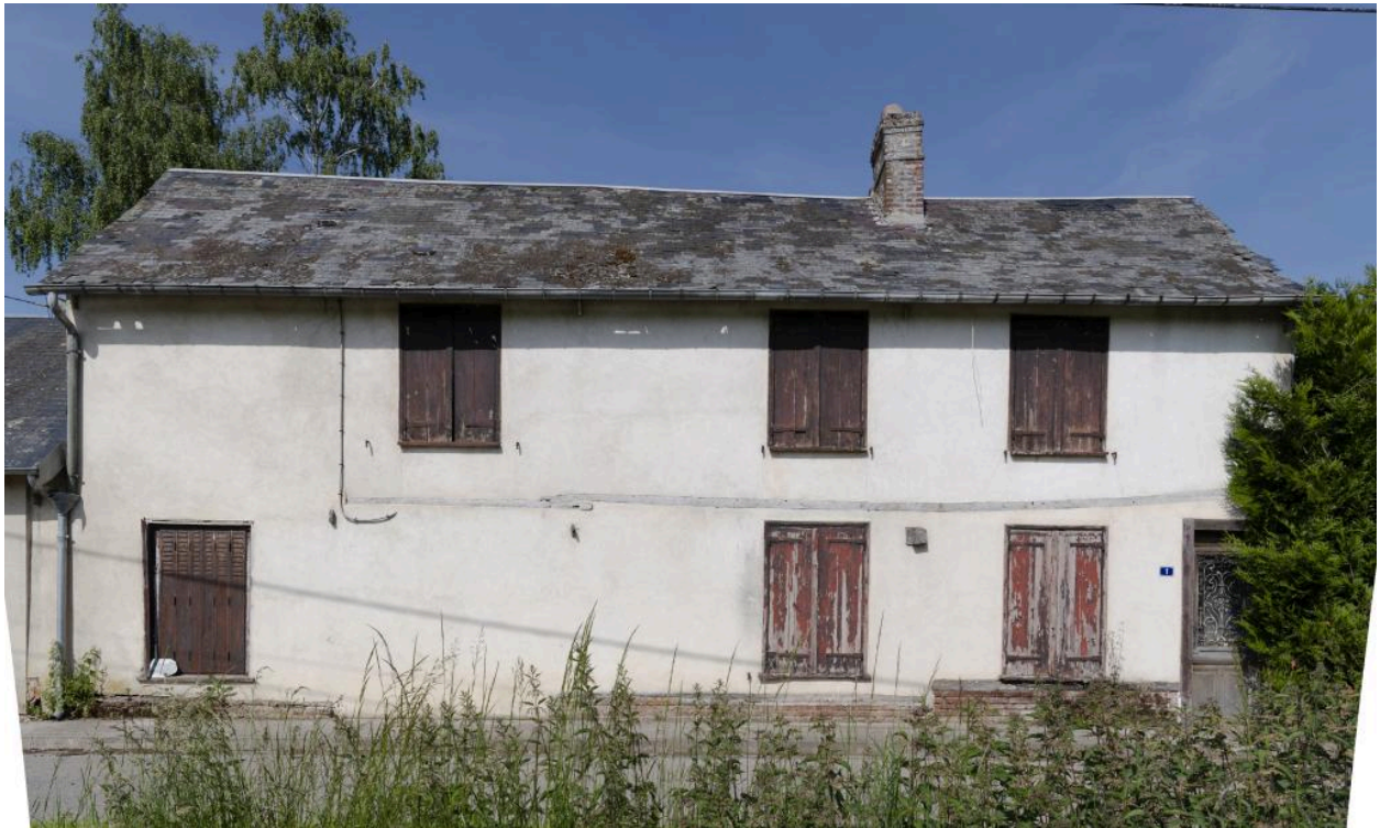
Logis sur rue, n°1 rue Cour Marin, vue de la façade depuis l'est.
