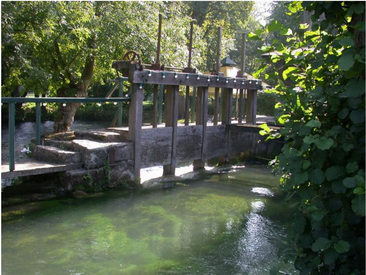
Les vannes de décharge et le repère de niveau des eaux.
