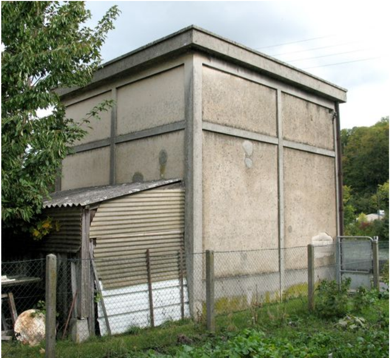
Le transformateur électrique vu vers l'Oise.
