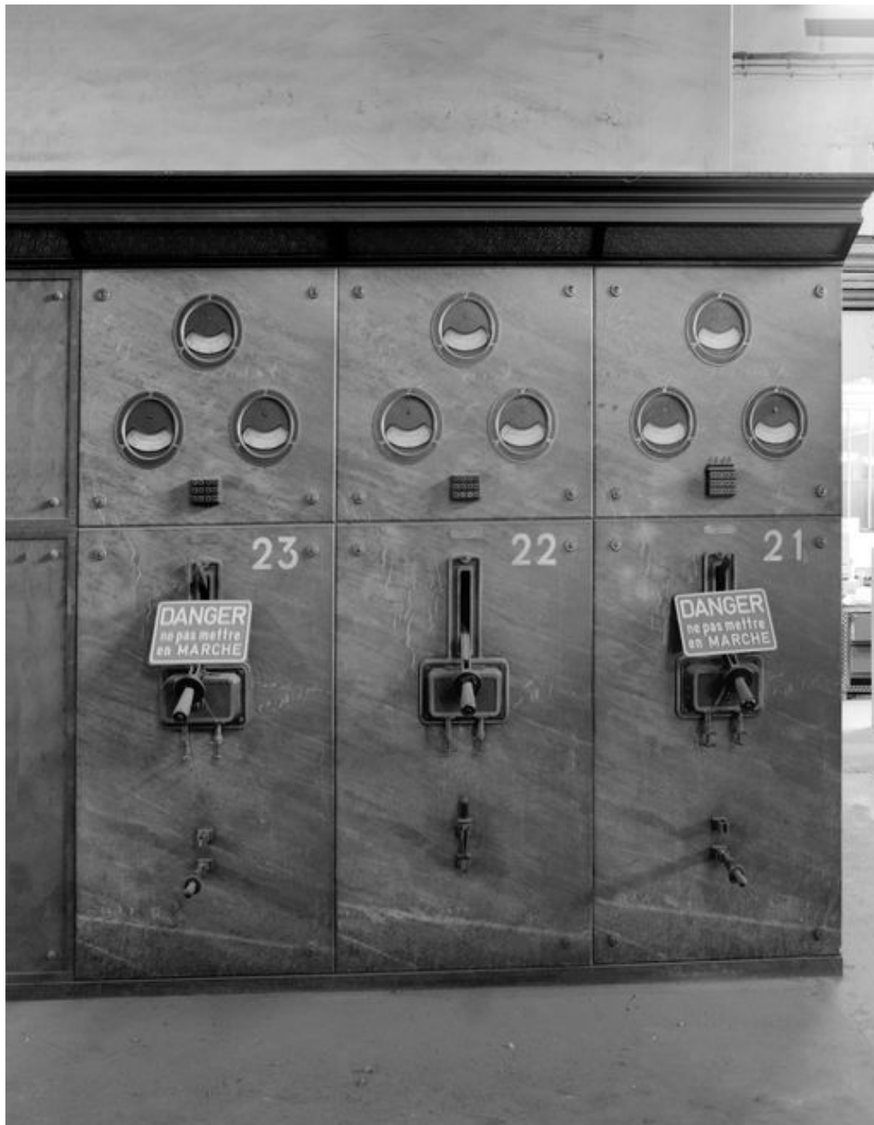
Armoire électrique en 1988.
