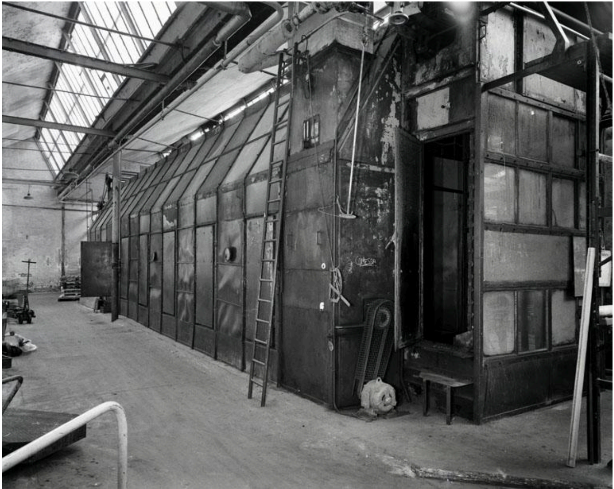
Sécheuse installée dans l'atelier des apprêts.
