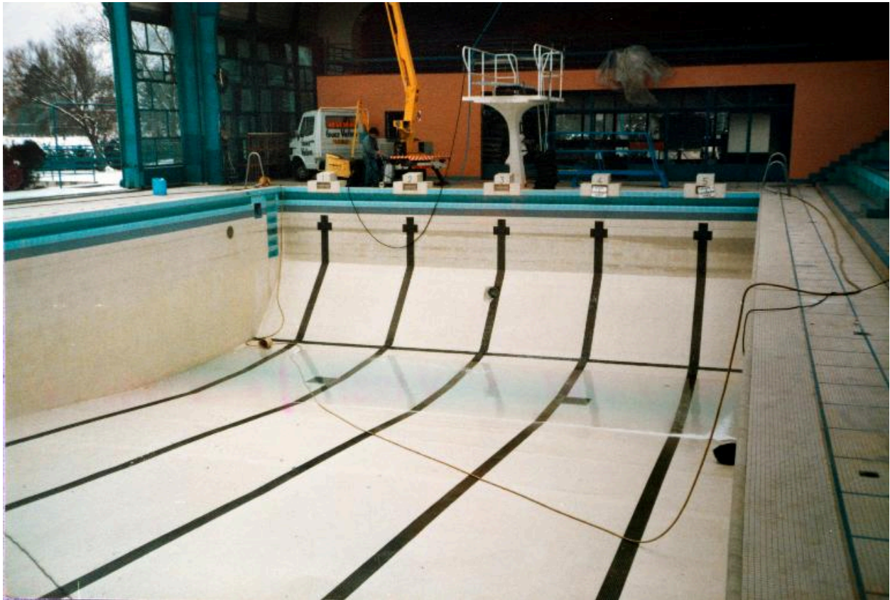
Vue du bassin sportif vide (3,5 mètres de profondeur) lors de travaux, vers 1990 (archives de la piscine).
