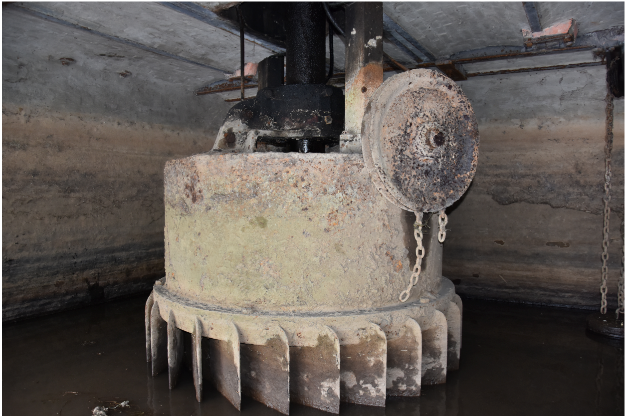
Une des turbines de l'usine.
