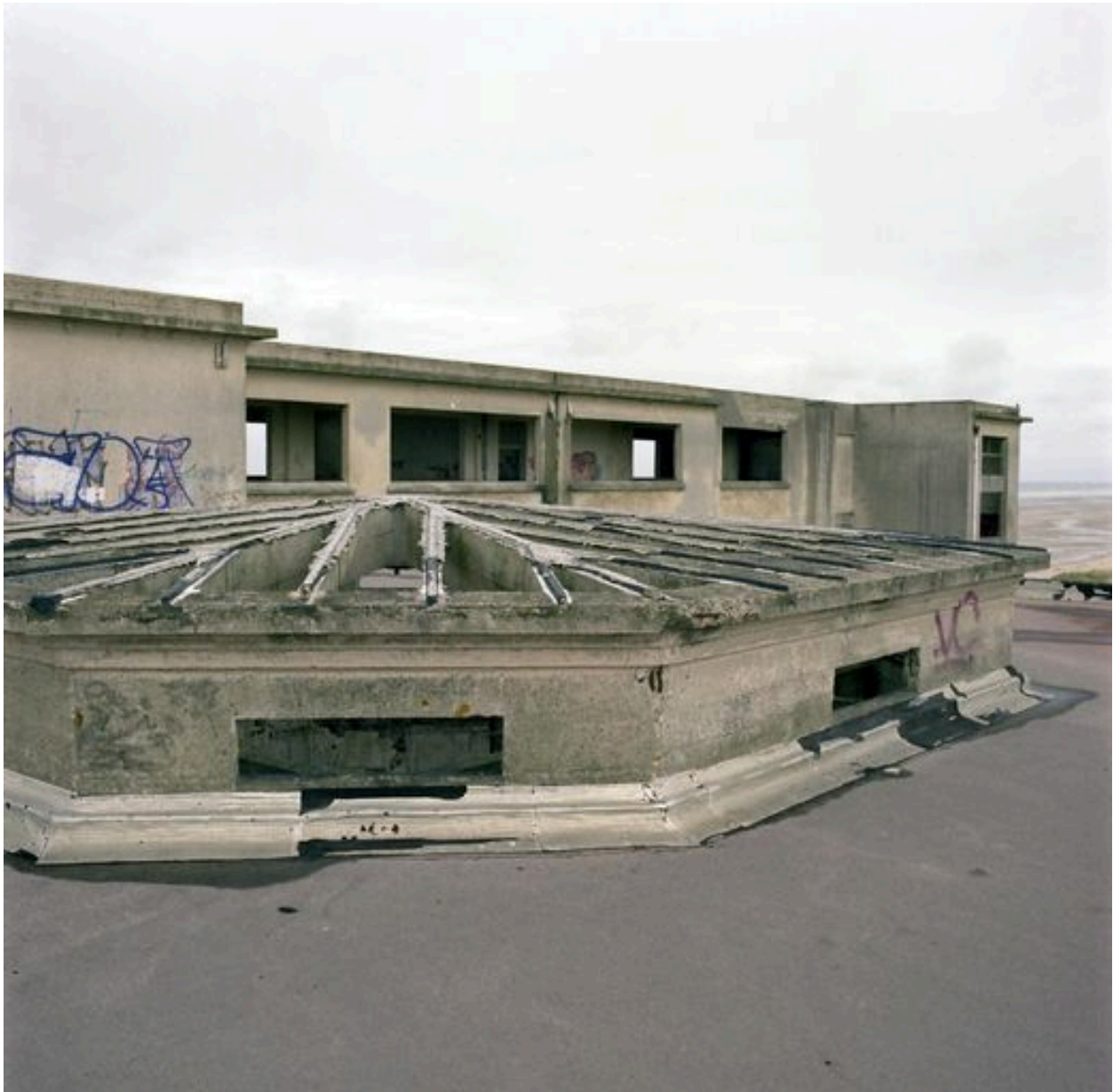
Aile devant renfermer les services médico-techniques, située sur l'arrière du bâtiment d'hospitalisation, couverture de la salle d'opération, vue prise de l'extérieur.
