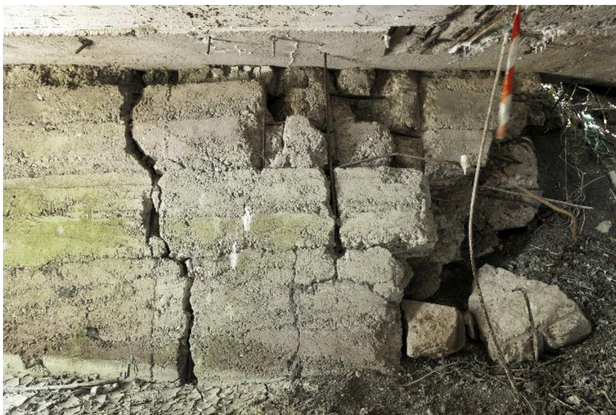
Partie du mur ouest, effondrée
