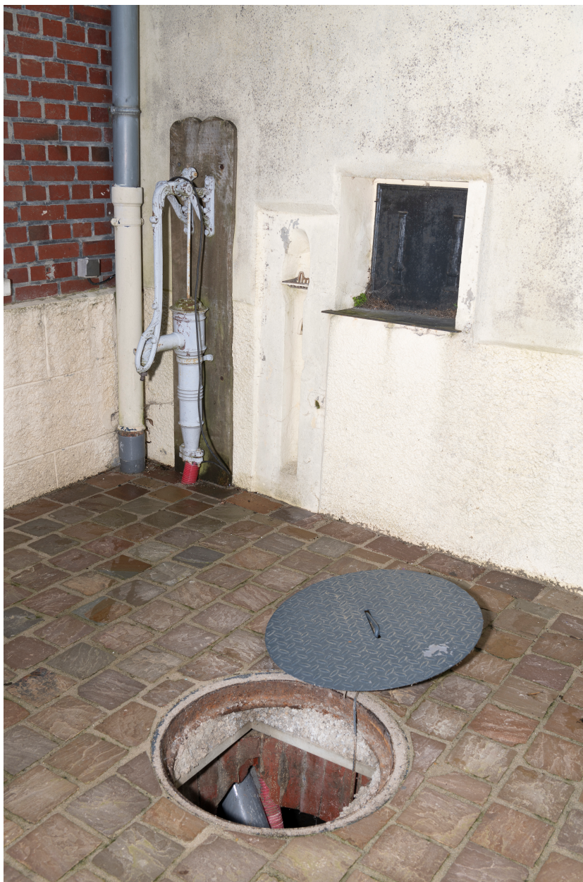
Citerne enterrée en brique avec pompe, n°3 de la rue de la Plaine.
