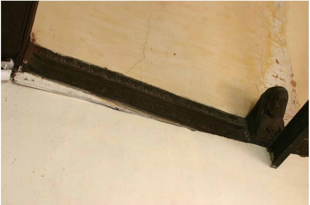
Vue détaillée de la sablière haute de la nef avec motifs géométriques et blochet bûché.
