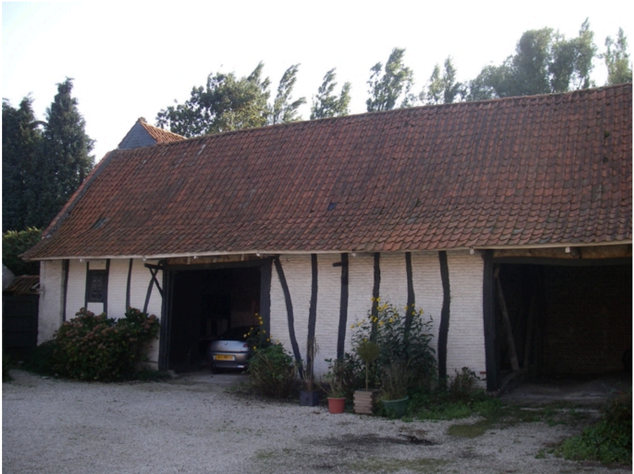
Grange de ferme (vestige de pan de bois et torchis) 562, rue Stanislas-Machynia, vue depuis cour.
