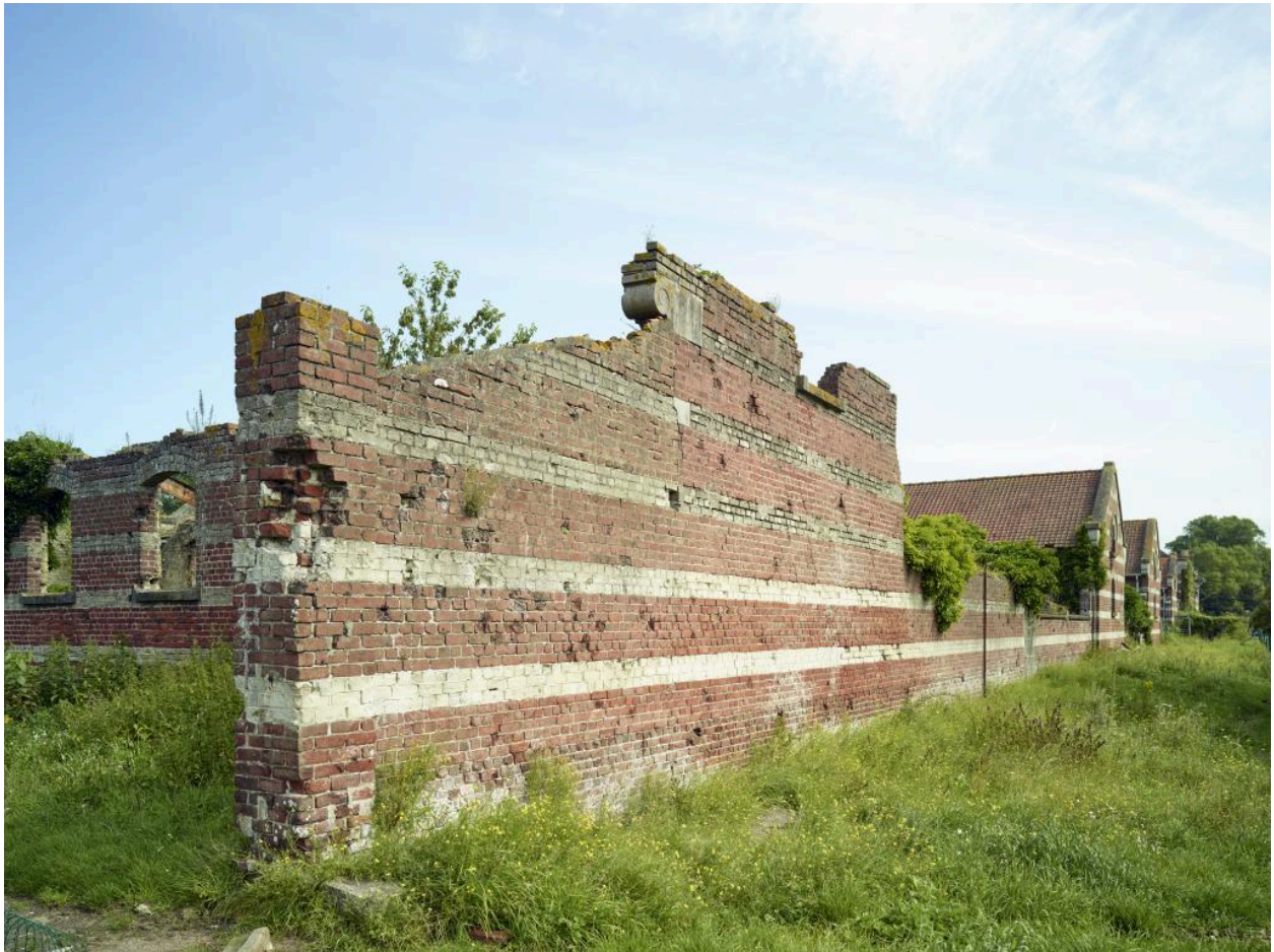
Mur de clôture sud de la ferme avec des pignons des bergeries et porcheries en prolongement.
